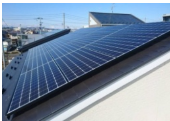
太陽光発電システム
